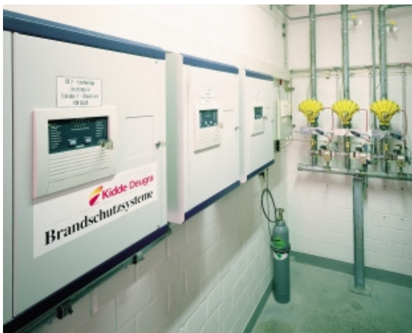
Zawory strefowe z centralami sygnalizacji pożaru
