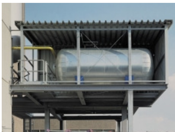
CO 2 - Zbiornik niskociśnieniowy
