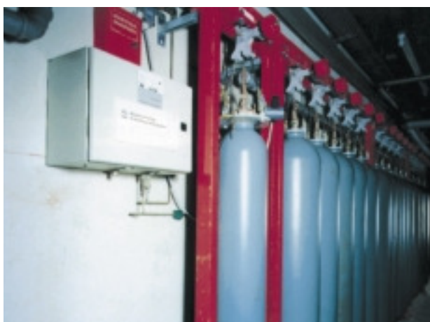
CO 2 - Instalacja wysokociśnieniowa z pneumatycznym opóźnieniem
