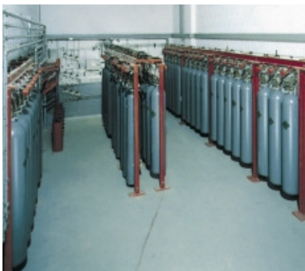
CO 2 - Instalacja wysokociśnieniowa
