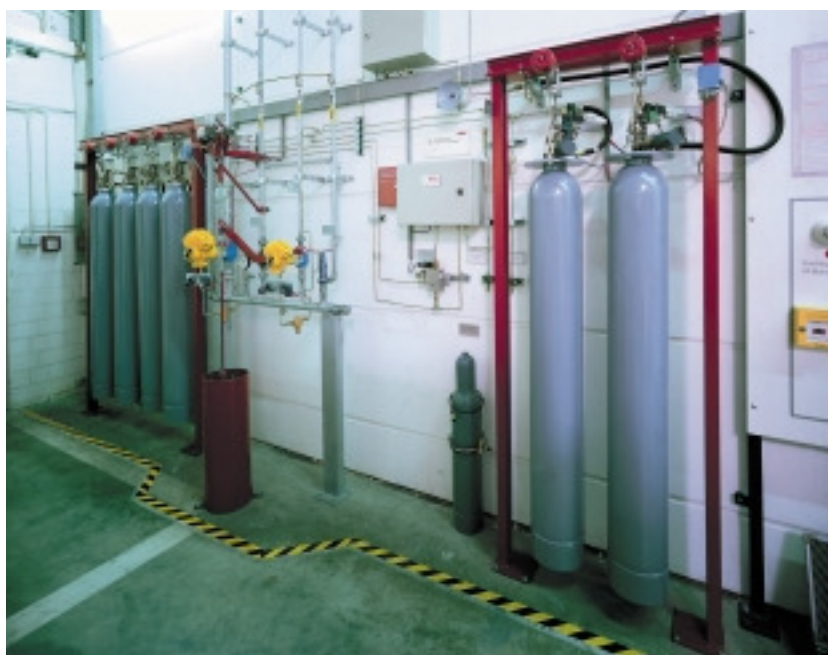
Bateria butli CO 2 z zaworami strefowymi i opóźniaczem pneumatycznym
