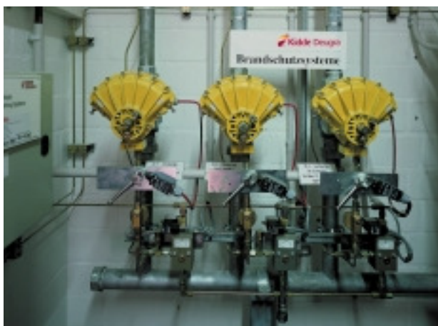
CO 2 - Zawory strefowe instalacji wysokociśnieniowej
