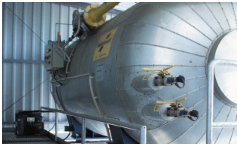
CO 2 - Zbiornik CO 2 z szafkami sterowniczym
