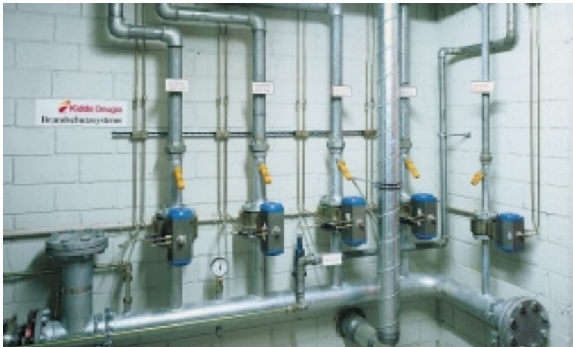
CO 2 - Kolektor z zaworami strefowymi instalacji niskociśnieniowej
